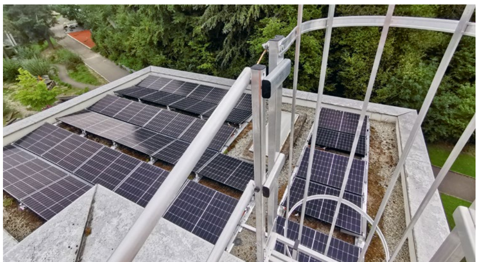
Die Gemeinde nutzt die Sonnenenergie und erstellt kontinuierlich Photovoltaikanlagen – 2023 auf dem Schulhaus Widacher (Bild).
