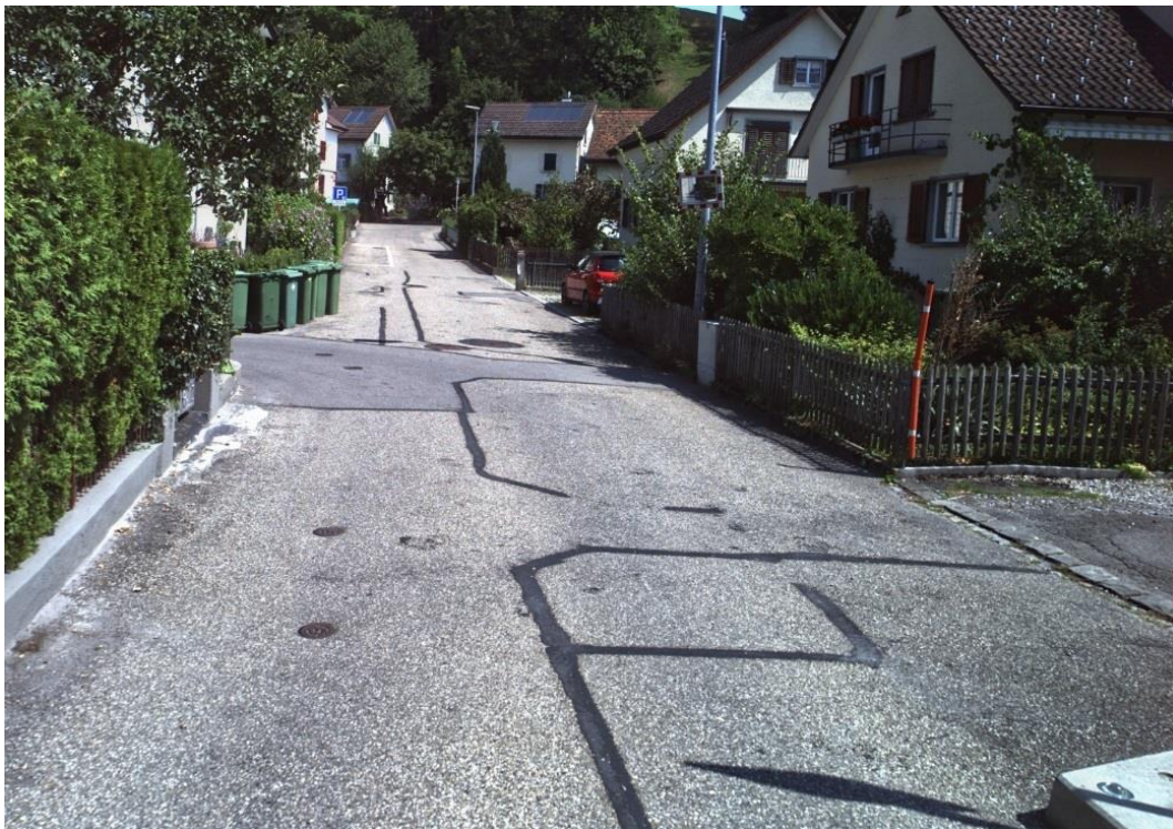
Bild: Konsumstrasse mit Ausmagerung, Rissen, Belagsflicken, defekten Randabschlüssen
