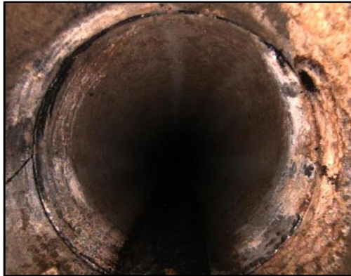
Bild: Inkrustation an der Rohrverbindung
