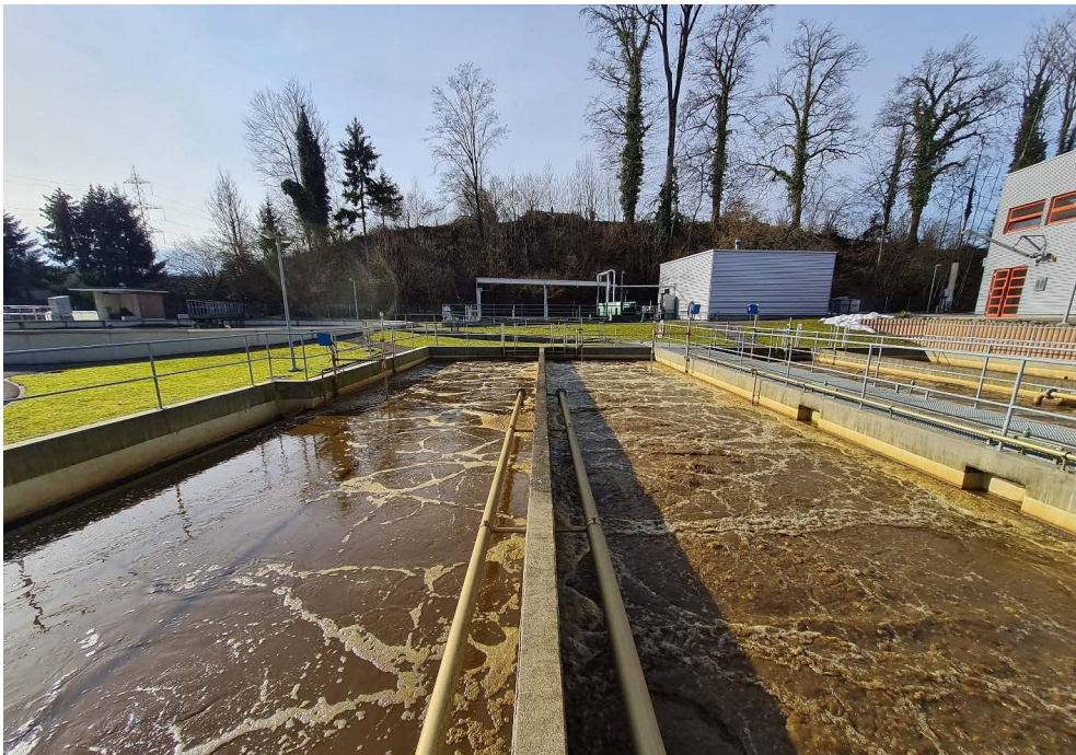
ARA Rüti – Biologiebecken 1
